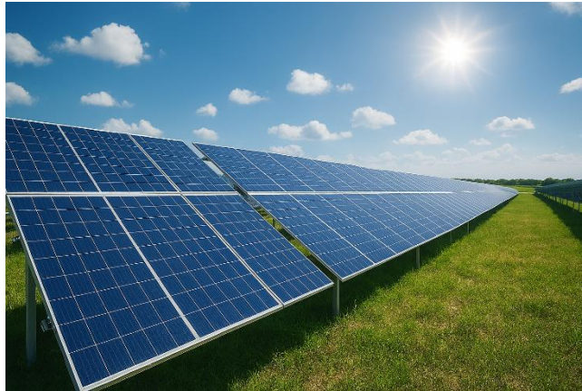
Figura 1: Producción de energía solar fotovoltaica.
