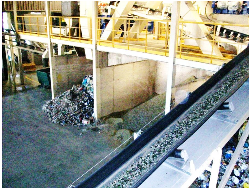
Figura 10: Planta de tratamiento BA Vidrio Distribución y Comercialización de Envases, SA.
